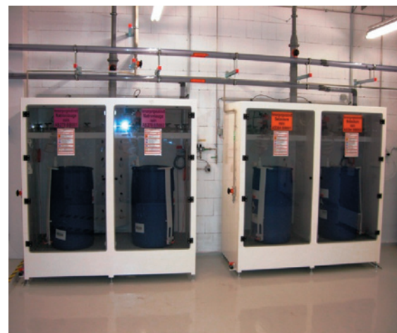
Kabinett zur Chemikalienversorgung mit doppelwandigen Rohren.
